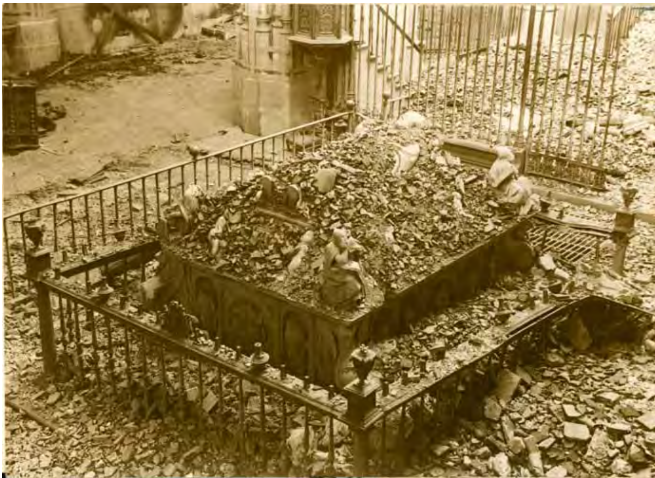
Figura 3. Estado del sepulcro de Cisneros cubierto de escombros tras el desplome de las bóvedas de la Magistral de Alcalá de Henares. Donación Vaamonde Horcada. IPCE. Ministerio de Cultura.
